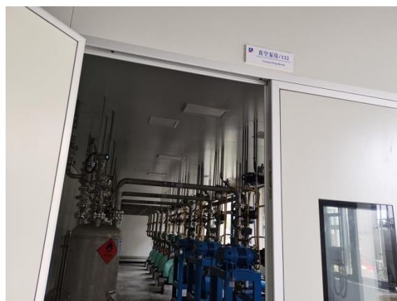
512 车间真空泵房
