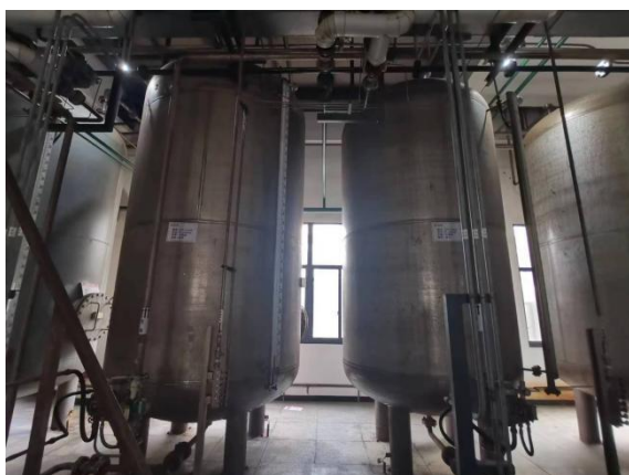
513 车间高浓废水收集罐
