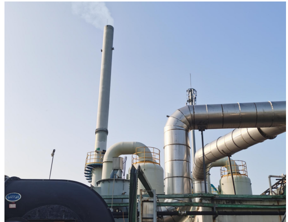
RTO 排放口 DA002
