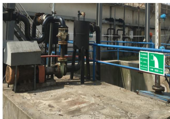
废水总排口 DW001
