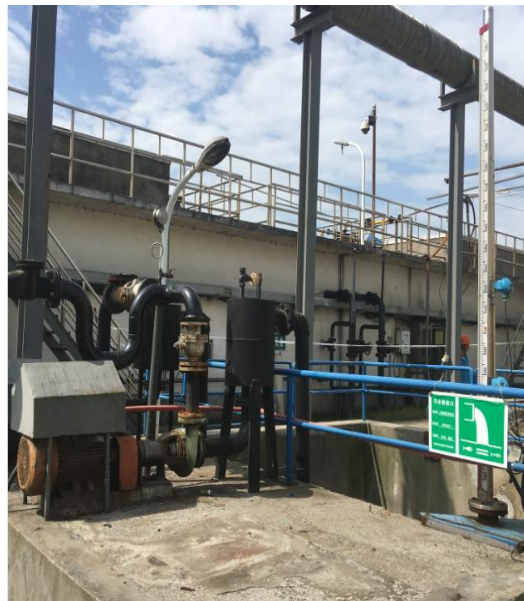
废水总排口 DW001
