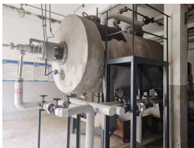
污水站蒸发脱盐装置
