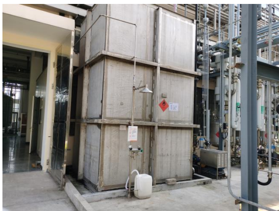
512 车间高浓废水收集罐
