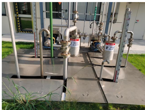
512 车间低浓废水收集罐
