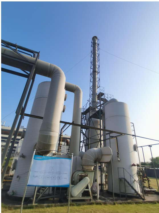
污水站好氧池废气处理装置
