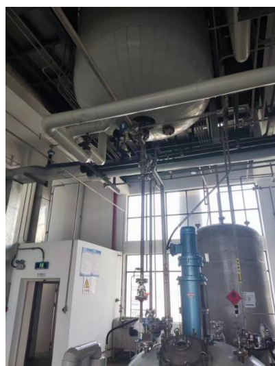
512 车间蒸馏脱溶装置
