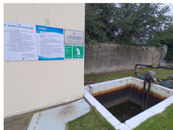
污水站北雨排口 DW003
