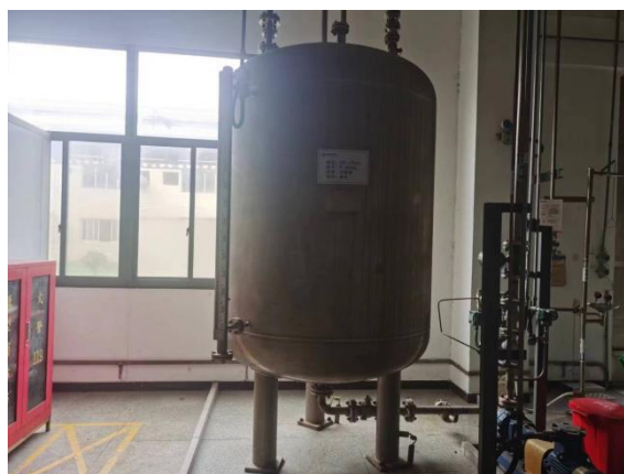
513 车间低浓废水收集罐
