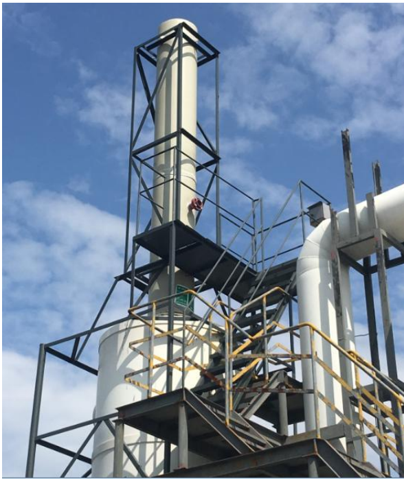
516 车间排放口 DA001
