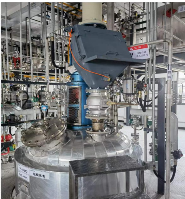
513 车间咪唑投料口
