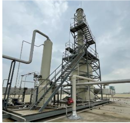
513 车间废气处理设施
