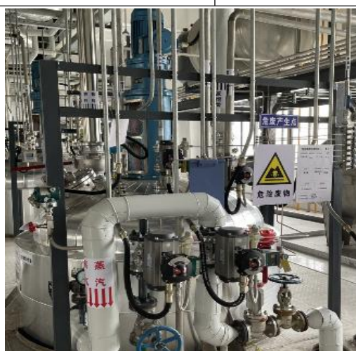
513 车间蒸馏脱溶装置
