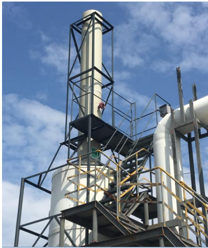
516 车间废气处理设置
