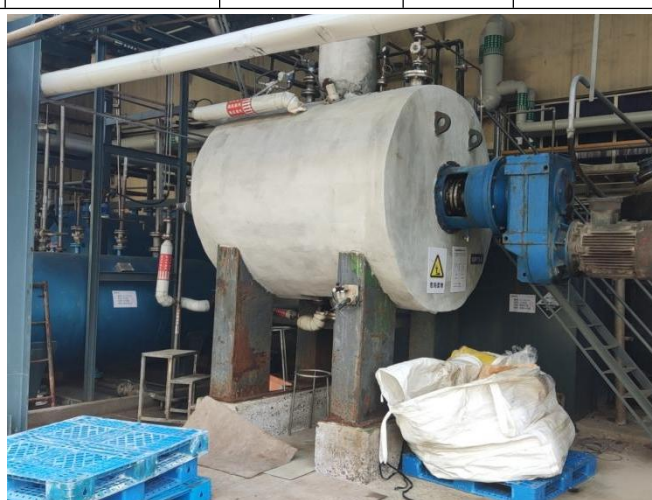
515 车间蒸发脱盐装置
