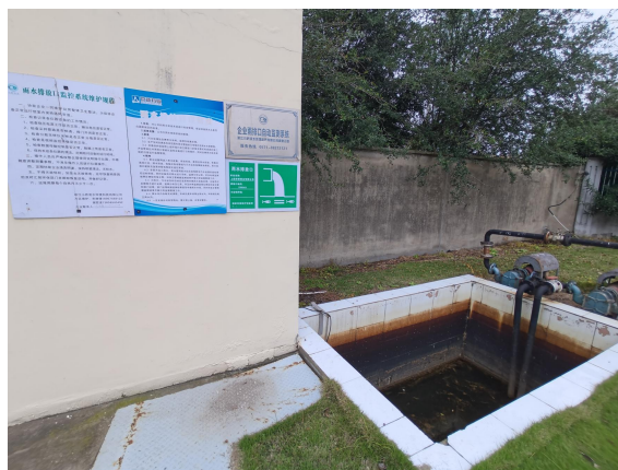
雨排口监控系统及污水站北雨排口 DW003
