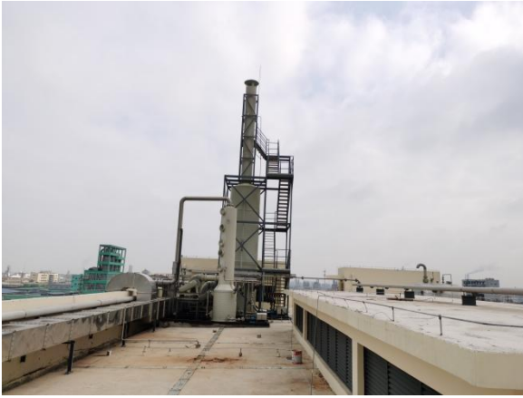
512 车间废气处理设施
